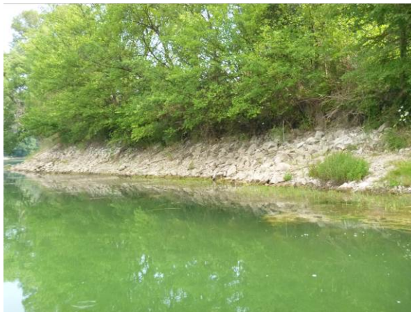
Carcès UO n°3 –talus
